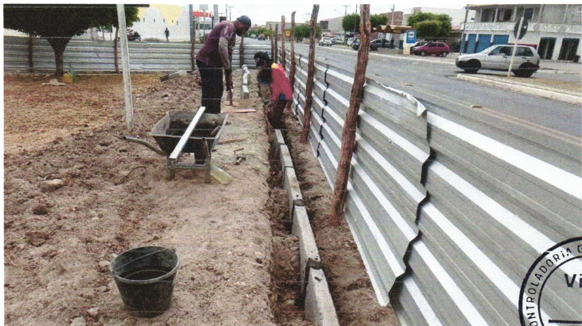
Foto 04 - ASSENTAMENTO DE GUIA (MEIO-FIO) EM TRECHO RETO, CONFECCIONADA EM CONCRETO PRÉ-FABRICADO, DIMENSÕES 100X15X13X20 CM (COMPRIMENTO X BASE INFERIOR X BASE SUPERIOR X ALTURA), PARA URBANIZAÇÃO INTERNA DE EMPREENDIMENTOS. AF_06/2016_P
